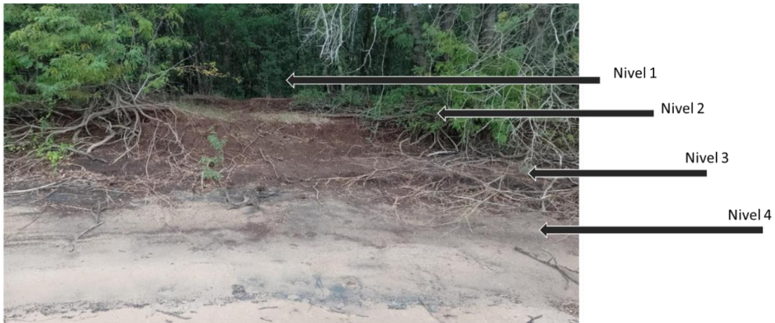
Fig. 2.2.2.2. Área de retroceso costero donde se visualiza una estructura escalonada.
