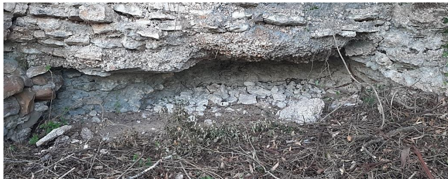
Vista del Socavón Norte en noviembre de 2022.
