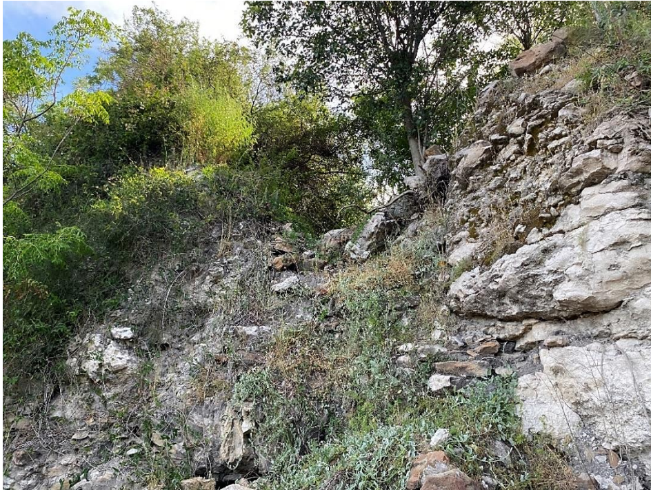
La parte alta del exterior del Horno 2 en el estado en que se encuentra. Corresponde al tramo del muro de contención que se derrumbó en 2016.
