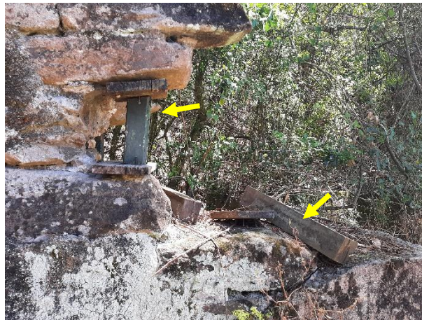
Detalle del apuntalamiento ubicado en el extremo derecho de la imagen anterior. Nótese el estado del mismo.
