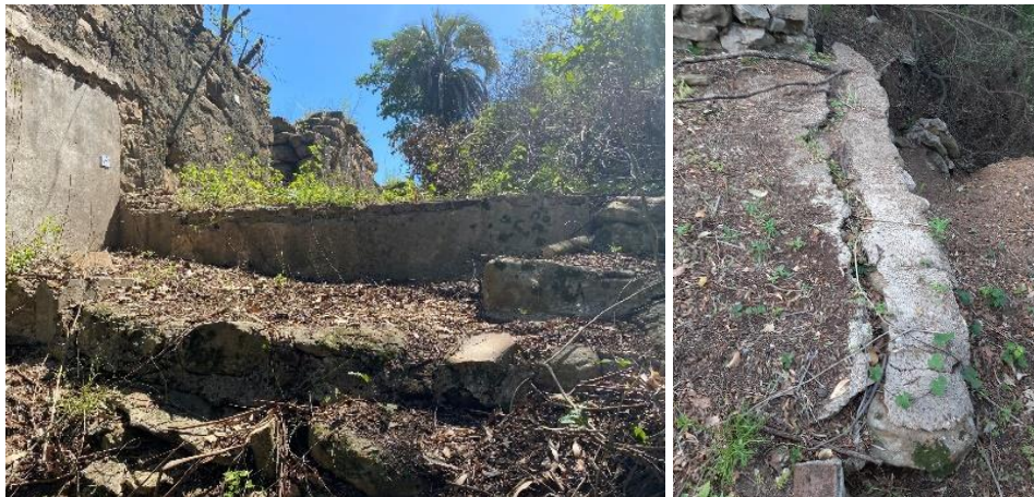
Vista de las plataformas que se encuentran junto al muro norte del Depósito (izq.) y detalle del borde donde el piso está a la vista (der.).
