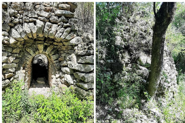
La boca de descarga con el arco descendido (izq.) y el árbol que ha crecido sobre el muro de contención (der.).
