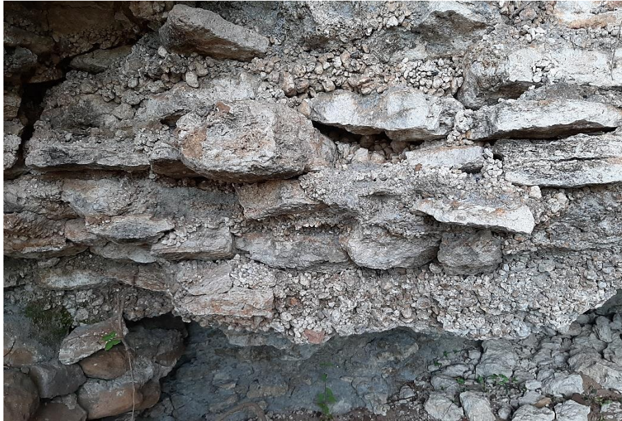
Vista de un sector del relleno artificial sobre el Socavón Norte en que se observan las capas de piedras intercaladas con una suerte de hormigón y las oquedades intersticiales.
