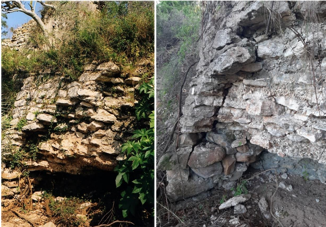
Imagen del muro de contención en 2003 (Archivo APN-PNEP) y noviembre de 2022. En esta última se observa la desvinculación entre los mampuestos del muro de contención y el relleno cultural que se encuentra por detrás.
