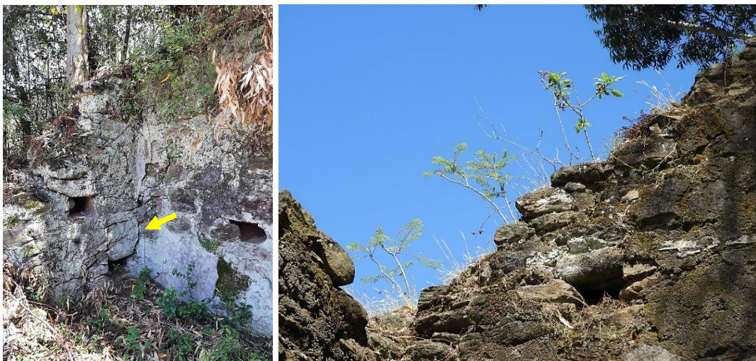
La grieta en el ángulo noroeste del recinto (izq.) y la vegetación que se encuentra en las cabeceras de los muros (der.).
