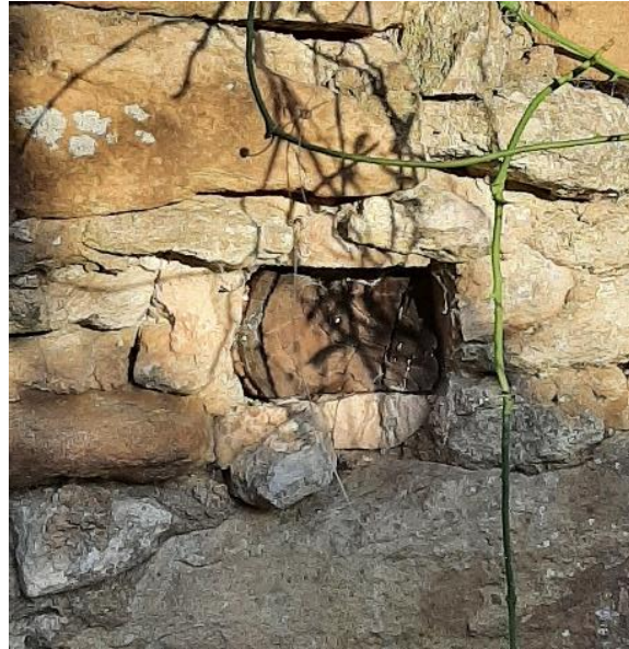
Vista del hueco que conserva el taco de madera de la viga en el interior, que -como se dijo anteriormente- es el que se sitúa más cerca del vano del muro este.
