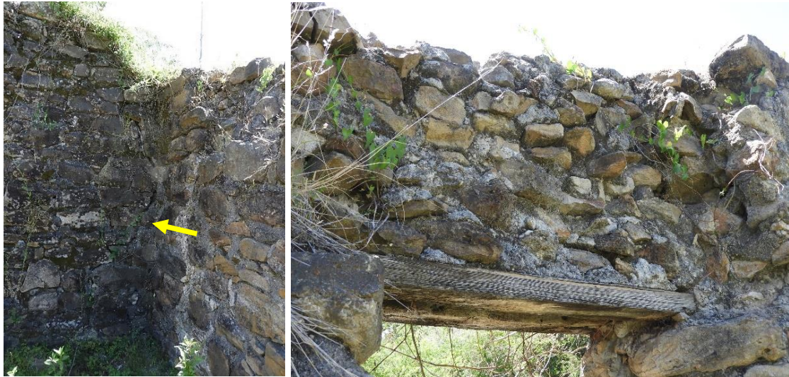
La grieta del ángulo noreste (izq.) y los dinteles del muro este (der.).
