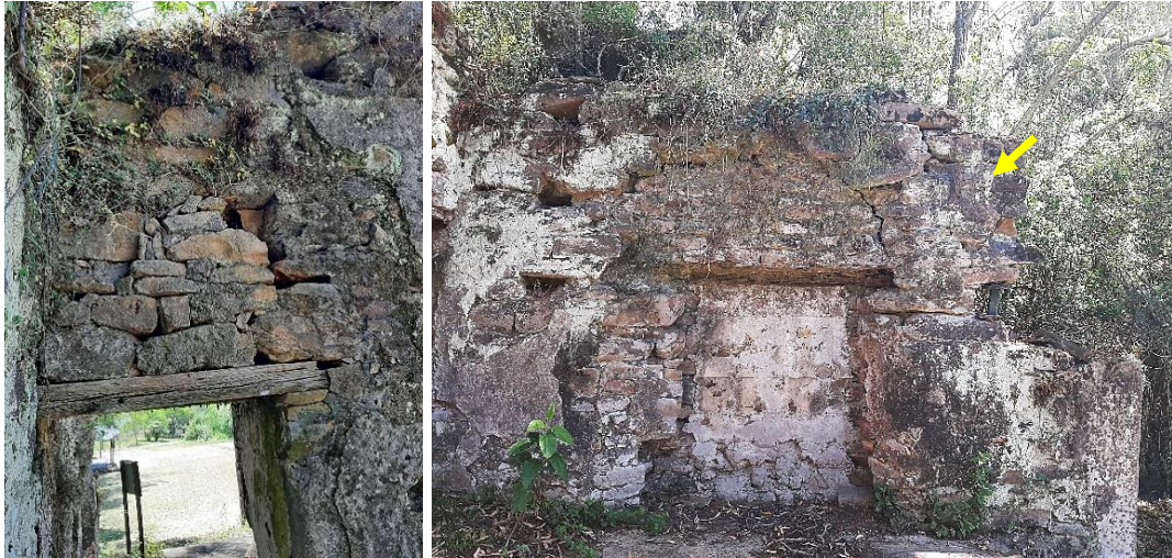
Dinteles del vano que separa los dos recintos de la Capilla (izq.) y del muro norte (der.). En ambos casos se observan las grietas y las mermas en la mampostería. Nótese que el fragmento de la derecha está desprendido (flecha).
