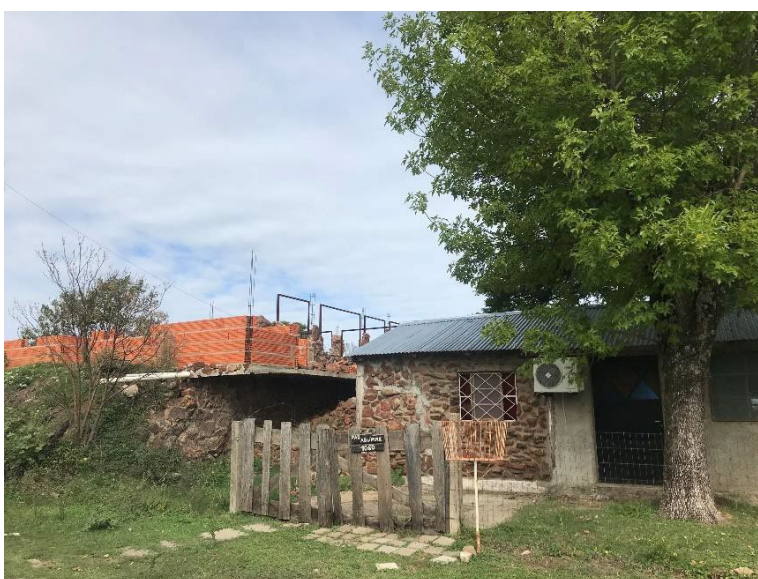
Imagen tomada en recorrida 19/04/2023 – vivienda en construcción en zona de riesgo alto
